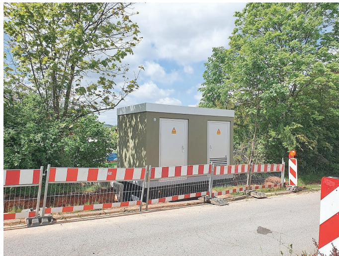
Neues Trafohäuschen an der Straße „Hinter dem Schloss“
