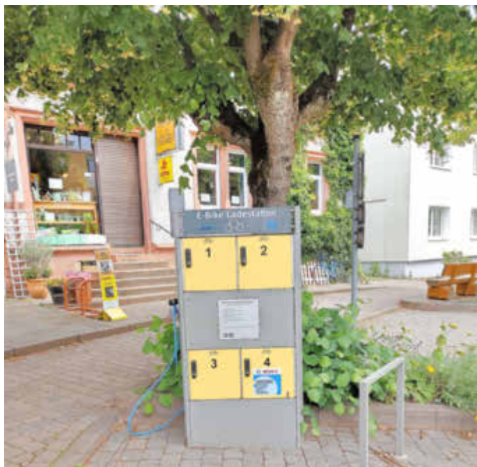
E-Bike-Ladestation Hauptstraße Limbach
