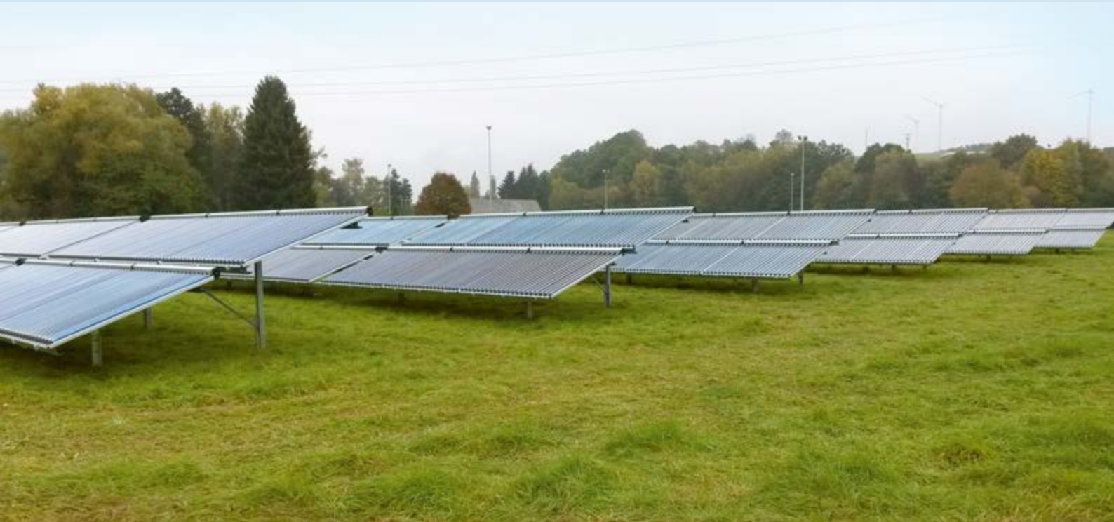
Das Solarthermiefeld soll das Wärmenetz in den Sommermonaten alleine versorgen können
