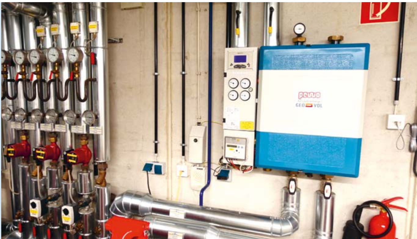
Übergabestation zwischen Fernwärme- und Hausnetz
