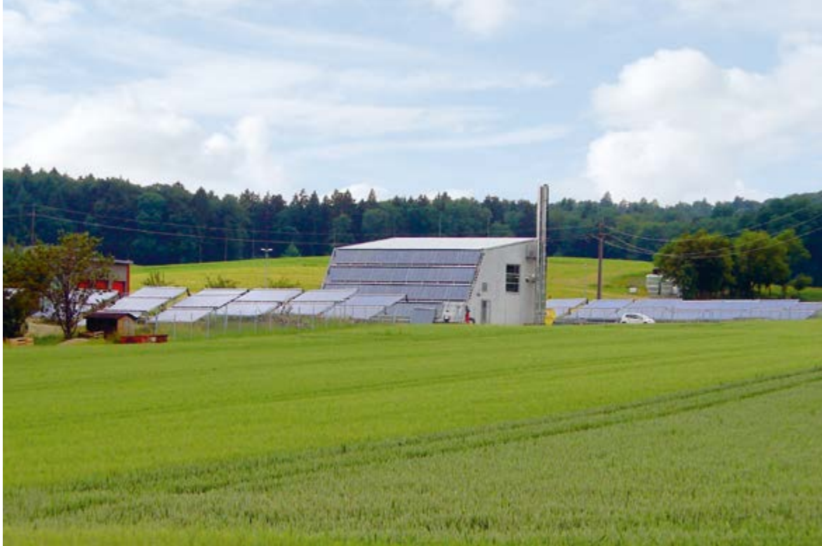
Heizwerk und Solarwärmefeld im Energiedorf Büsingen
